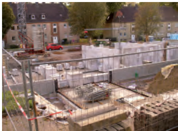
Mittleres und unteres Foto: Baustelle Südring 23, Hattingen, Projekt „wir wohnen zusammen e.V. / hwg eG
